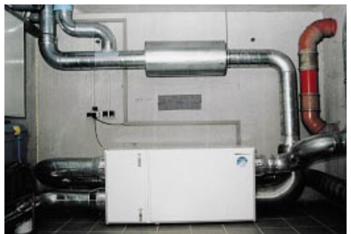
Lüftungsanlage mit Wärmetauscher
